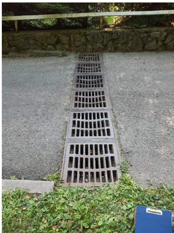
Dešťové vpusti napříč komunikací pod vstupem do obory Holedná
