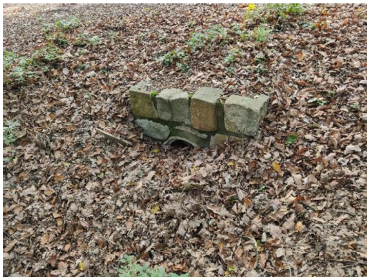
Zanesená výúst z propustku v extravilánu
